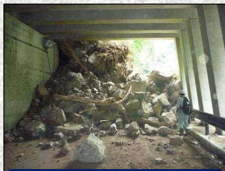
道路を塞いだ岩塊（ロックシェッド内）
