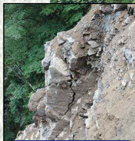
残った岩塊の亀裂
